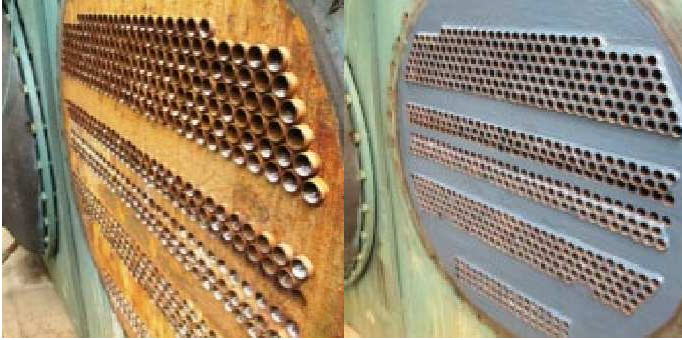
Výmenník tepla natretý kvôli ochrane pred eróziou a koróziou
