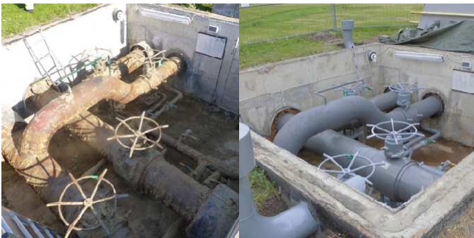
Natreté skorodované potrubie
