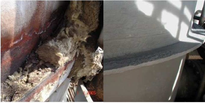
Ochrana proti korózii pod izoláciou na nádobe
