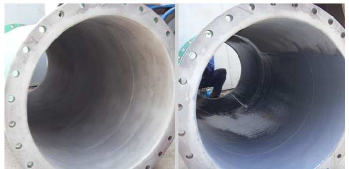
Výtlačné potrubie chránené pred pôsobením kyslého kalu
