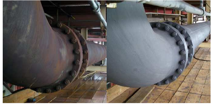
Protikorózný náter pod izoláciou na horúcom potrubí
