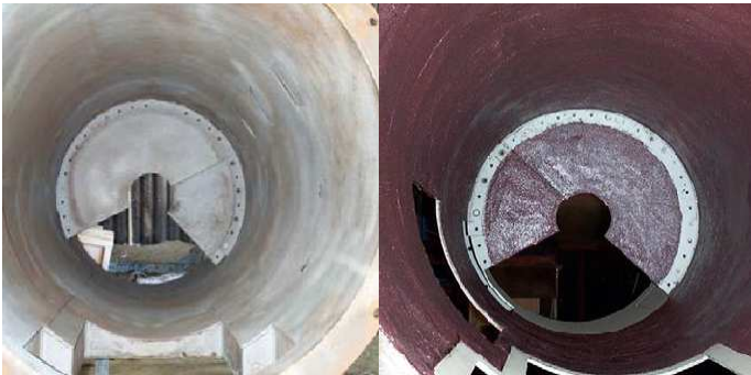
Miešacie zariadenie zatmelené a chránené pred abráziou
