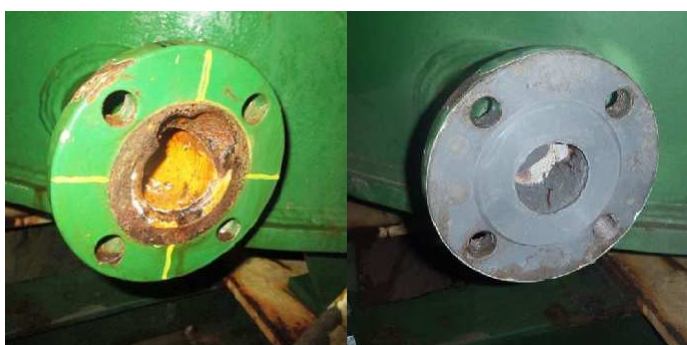
Opravené poškodenie čela príruby
