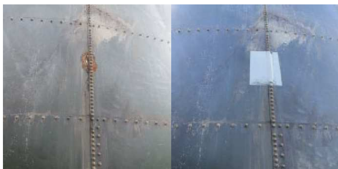
Poškodenie nádrže utesené záplatou
